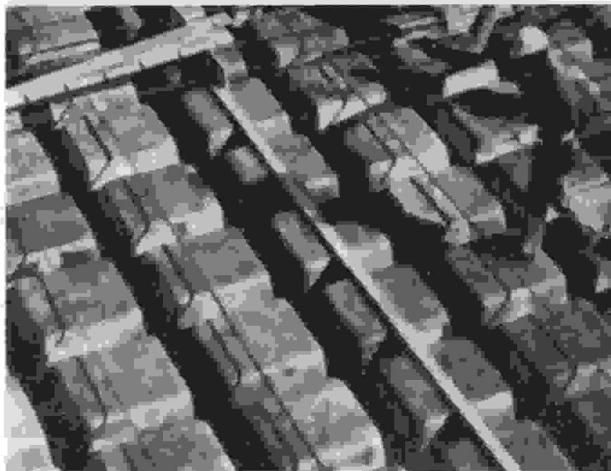
FIGURA 18.11 Construcción de un entrepiso de viguetas en dos direcciones con formaletas en forma de domo.
